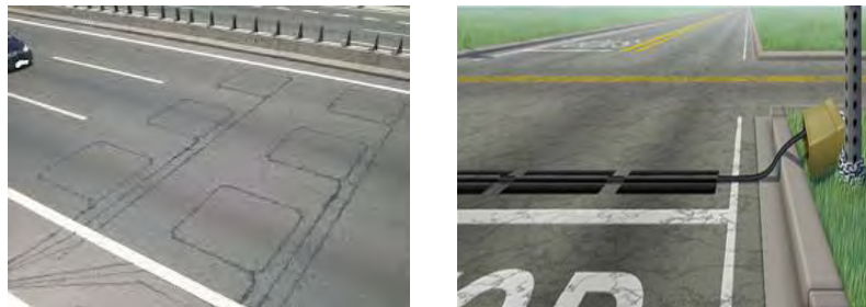
Figura 3. Sensores inductivos y mangueras instaladas en las vías
