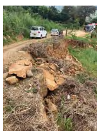
Figura 8. Socavación de la calzada vial por su proximidad al cuerpo de agua
