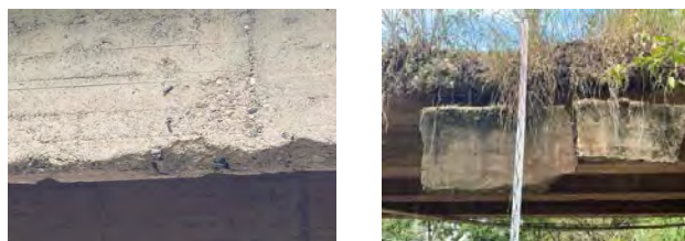
Figura 5. Viga de un puente con deterioro del concreto por abrasión, ocasionando la exposición del acero de refuerzo (izq) y colapso de una viga por impacto de material transportado por el río
