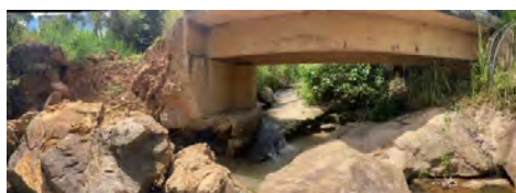
Figura 6. Socavación de un estribo y fundación de un puente, cimentado sobre material aluvial
