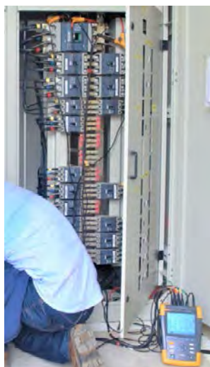
Figura 3. Conexión física a la salida del interruptor principal
