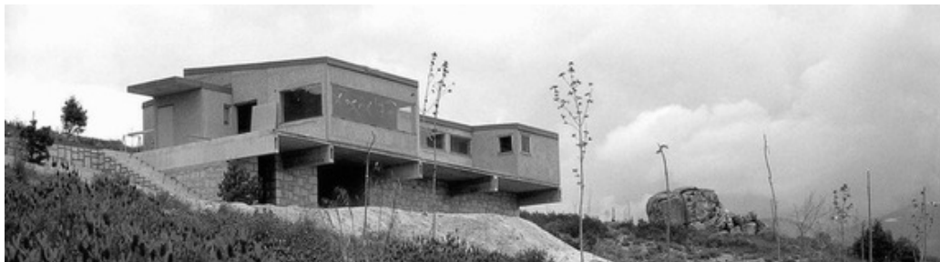
Figura 1: Vista general en construcción años 60 desde el sur Fuente: Fundación Alejandro de la Sota
