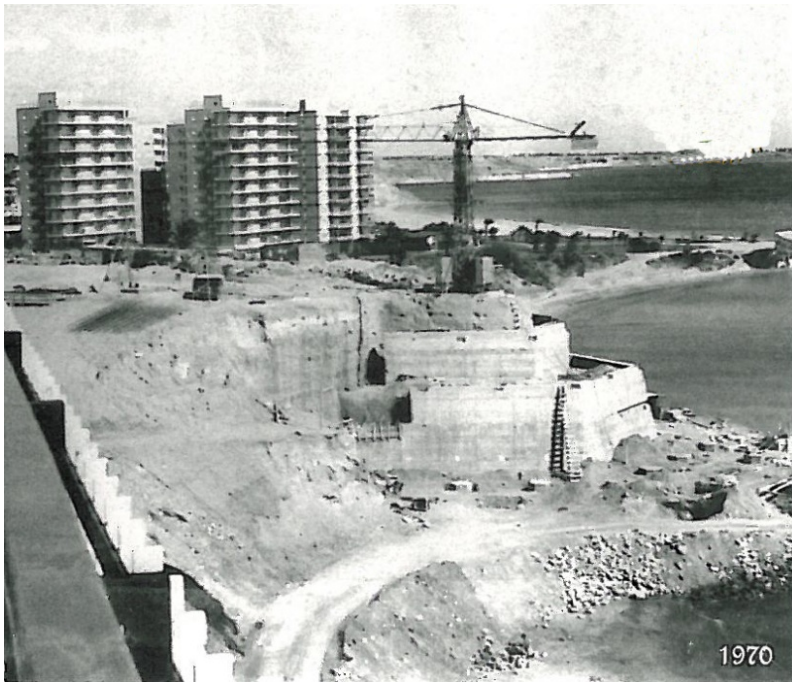
Fig.2. Fotografía de 1971, estado del movimiento de tierras y desmonte previo a la construcción del Club Náutico de la Dehesa de Campoamor. Fuente: Empresa Sudecasa -Servicios de Urbanización Dehesa de Campoamor-
